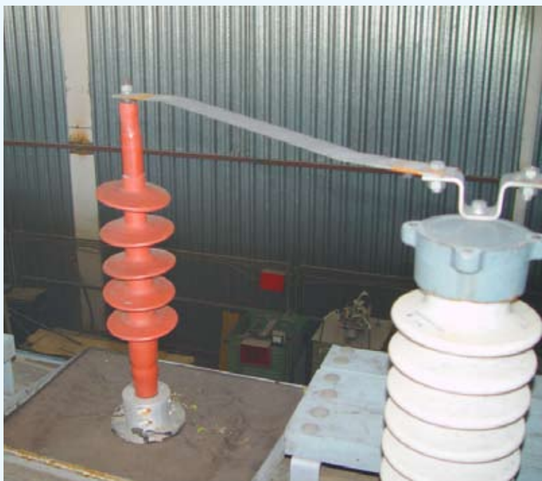
Рис. 3. Фото верхней муфты ввода кабельного ВК-25, установленной на крыше вагона электропоезда переменного тока
