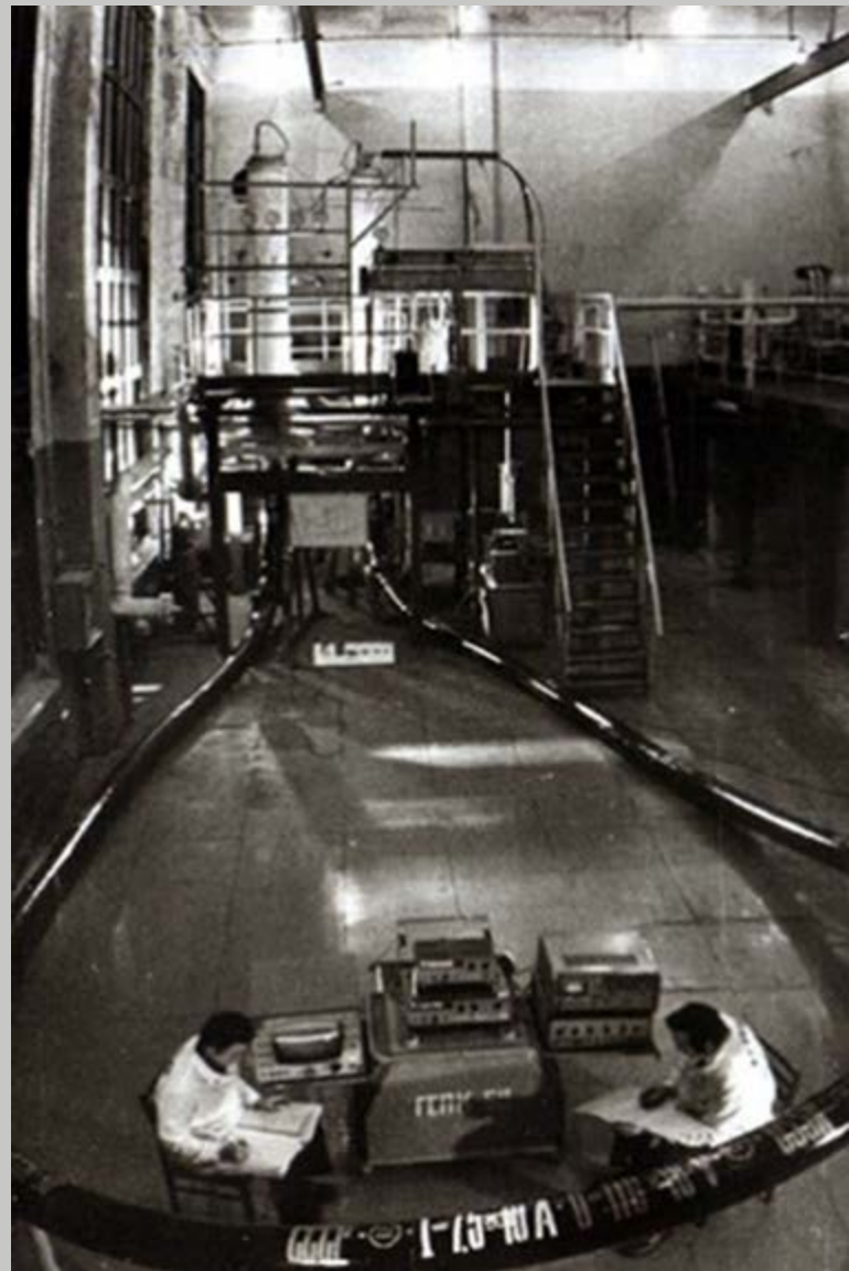
Рис. 4. Сверхпроводящий кабель на напряжение 110 кВ на испытаниях
