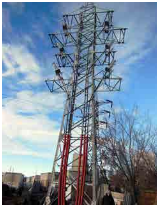
Рис. 10. Концевые муфты МКВ 126 и кабели, закреплённые на опоре ВЛ, с защитой кабелей в нижней части опоры полиэтиленовыми трубами
