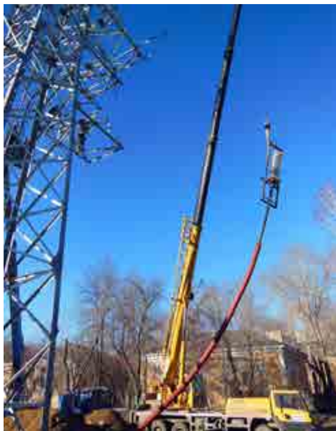
Рис. 7. Подъем МКВ 126, закрепленной на приспособлении, с помощью подъемного крана на опору ВЛ
